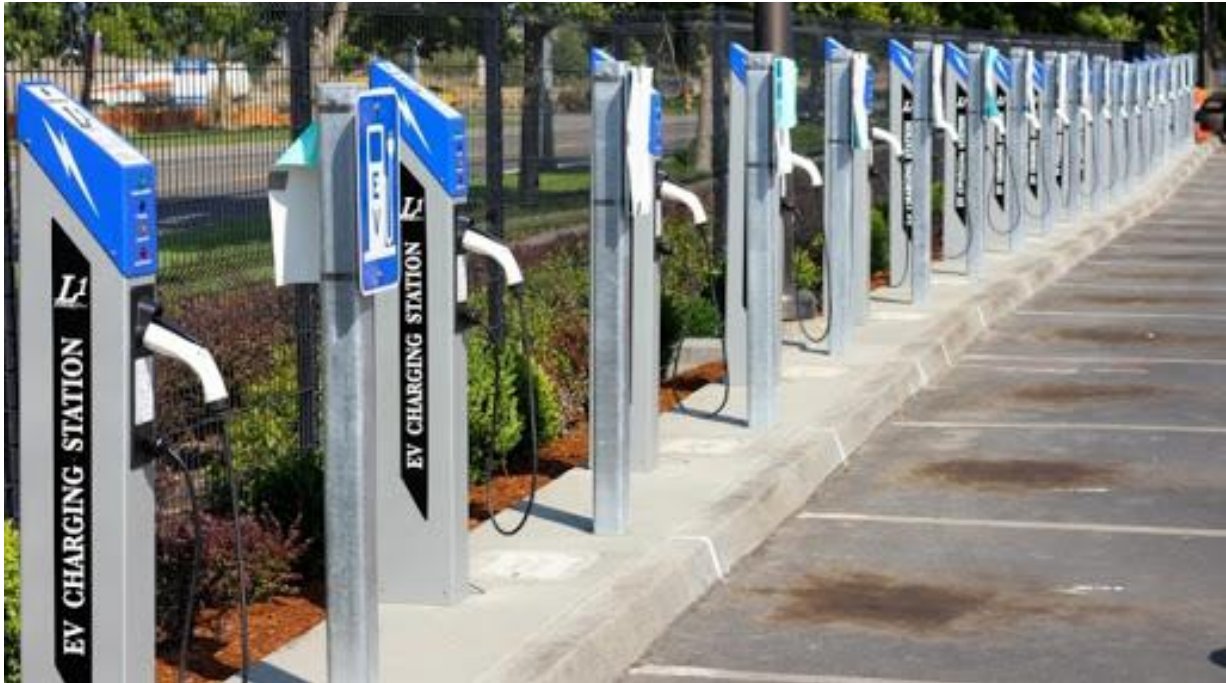
Εικόνα 20: Παράδειγμα σταθμών φόρτισης ηλεκτροκίνητων οχημάτων σε υπαίθριο χώρο.
