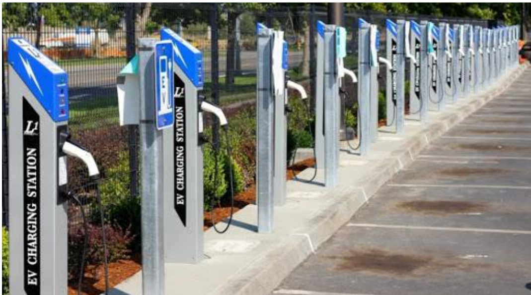
Εικόνα 21: Παράδειγμα σταθμών φόρτισης ηλεκτροκίνητων οχημάτων σε υπαίθριο χώρο.
