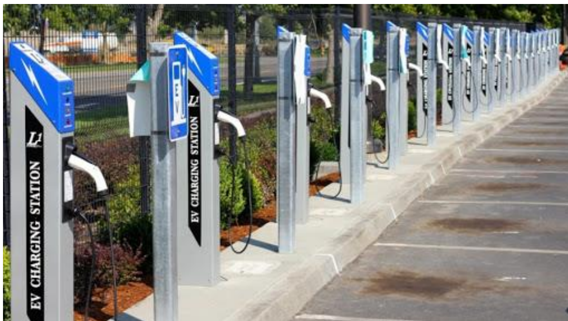
Εικόνα 9: Παράδειγμα σταθμών φόρτισης ηλεκτροκίνητων οχημάτων σε υπαίθριο χώρο.
